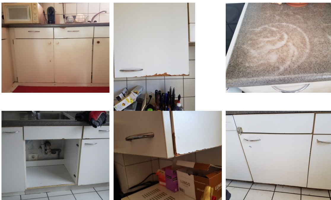
Photos cuisines vétustes Sous-Bois 17-23
