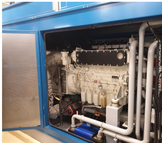
Figure 1: CCF actuel. Ces machines fonctionnent avec du biogaz issu de la méthanisation des boues des digesteurs et transforment celui-ci en électricité et en chaleur.
