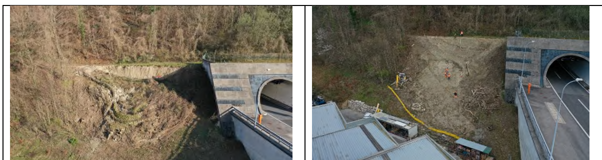
Figure 2 : Photographies de la zone de glissement (à droite de la photo : route nationale N1, portail du tunnel de Pomy). Photo de droite après les travaux forestiers. Photo de gauche, après la purge et le reprofilage du terrain.
